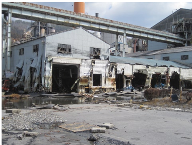
写真4 工場内建屋の損傷
