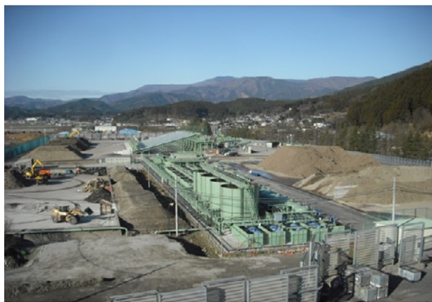
写真6 災害廃棄物処理・除塩設備
