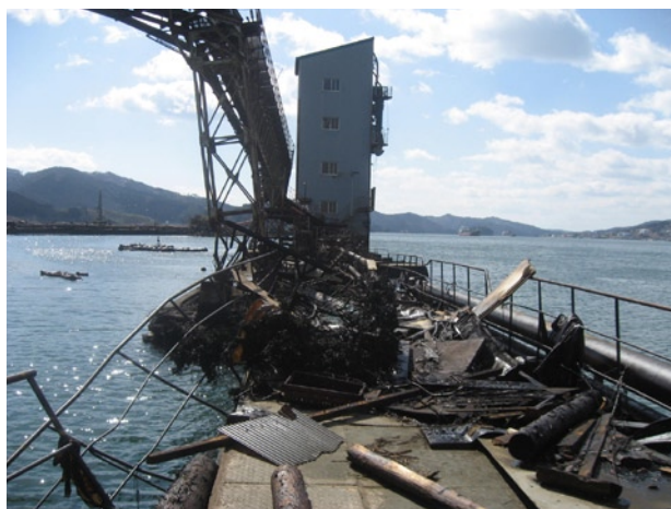
写真5 工場内出荷バースの損傷
