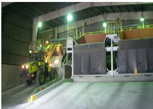
写真10 不燃系廃棄物処理設備
