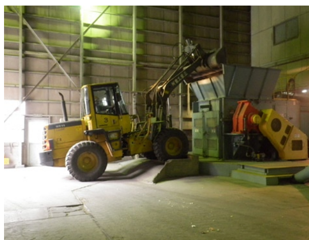
写真9 廃プラ破碎処理設備
