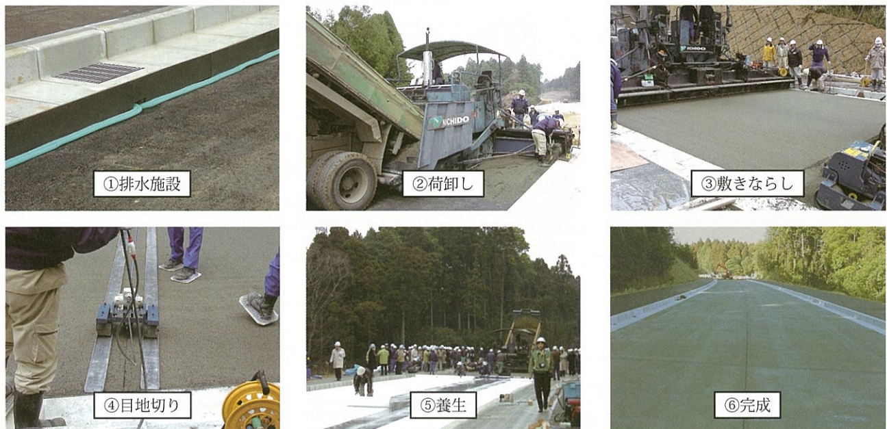
写真-1 アスファルトフィニッシャーを用いたポーラスコンクリート舗装の舗設（フルデプスタイプ）
