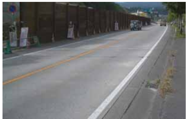
No.24、49号、福島県いわき市、供用39年
