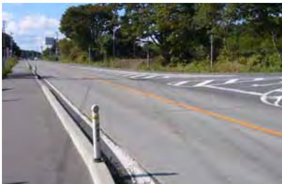
No.2、45号、青森県階上町、供用37年
