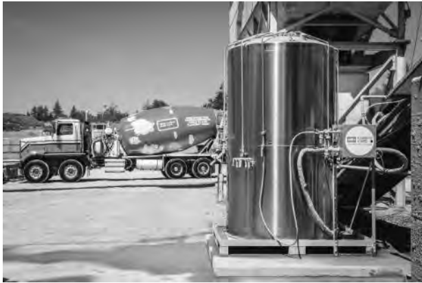
写真1 CC社ロゴをプリントしたアジテーター車とCC社関連装置 4)
