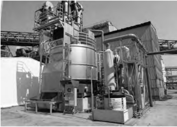
写真1 下水汚泥発酵乾燥設備の外観
