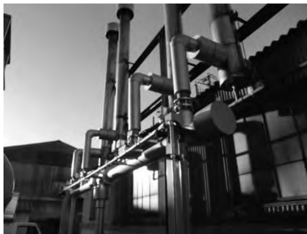
写真5 ボイラーの燃焼排ガスを排出する煙突
