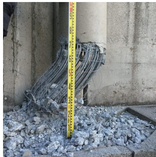
写真9 損傷したPC電柱
