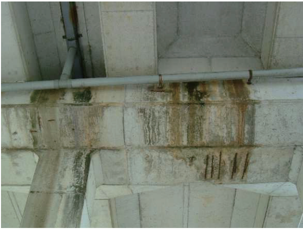
写真1 桁受部における鋼材露出 3)
