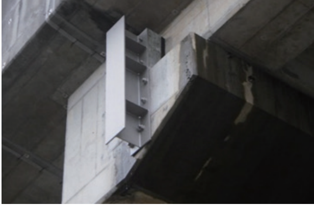
(a) 桁外側のサイドストッパー
