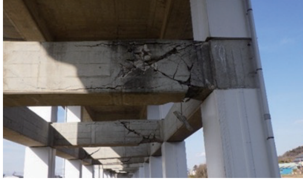
写真4 中層梁の損傷状況
