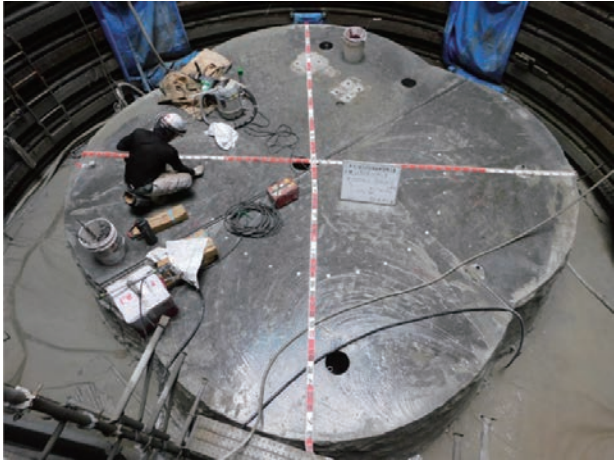
写真4 杭体切断面の状況(G.L.-15.5m付近)
