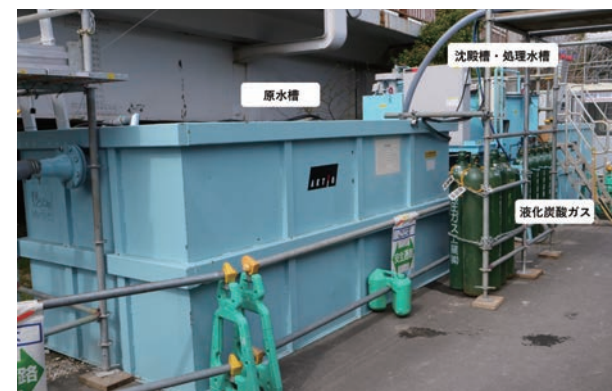
写真1 濁水処理装置の全景
