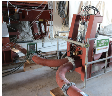
写真3 配管系統の高速切替装置
