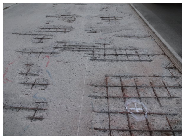
写真1 床版上面の劣化状況
