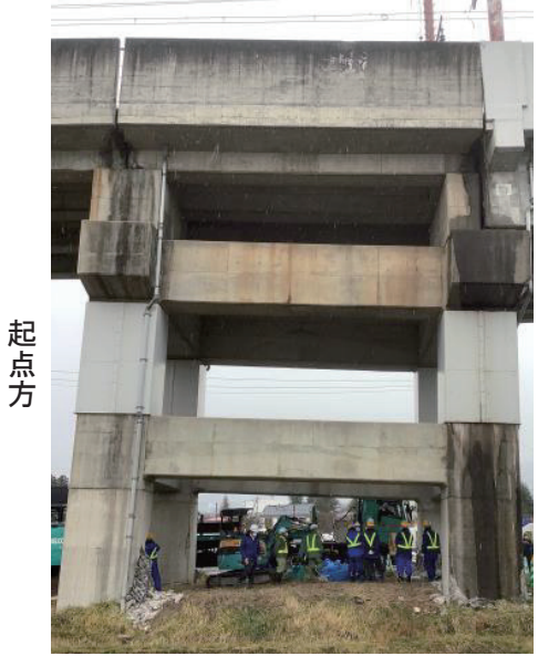
写真2 ラーメン橋台の被災状況(全景)
