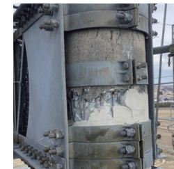
電柱上部の表面はく離
