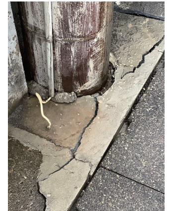
電柱基礎損傷
