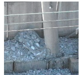
電柱基部の圧壊
