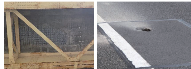
写真1 床版下面の変状 写真2 床版上面の再発状況
