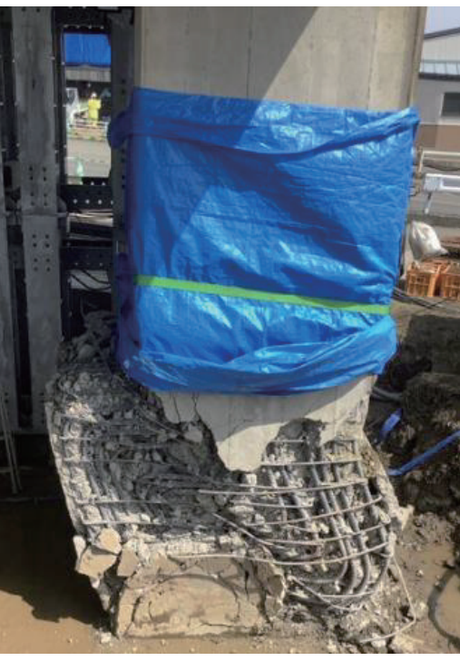
写真1 下層柱の損傷状況
