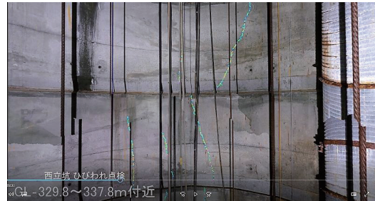
図7 ひび割れ点検結果の3次元表示
