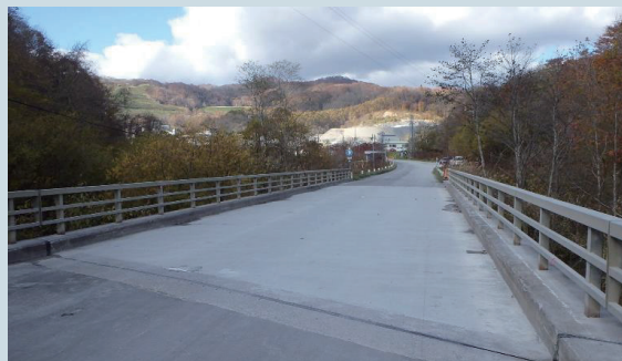
ラテックス改質速硬コンクリートを用いた橋面コンクリート舗装の実橋における供用性評価
