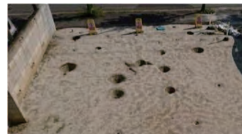
写真1 引抜き孔の埋戻し処理の不良に起因した局所的な沈下発生事例
