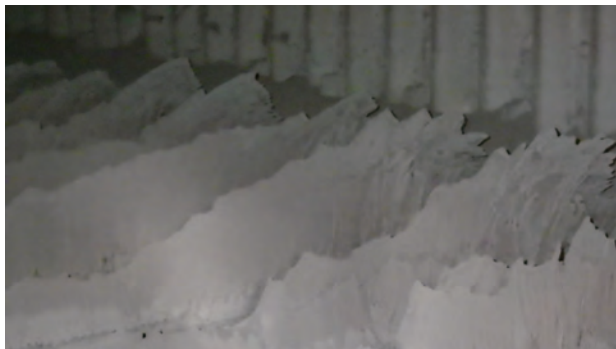
写真1 スケール発達状況
