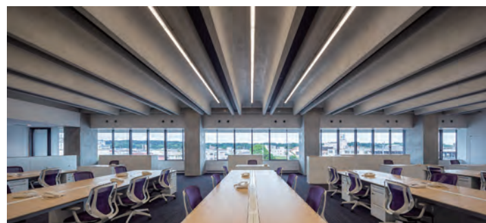
写真6 DT版を利用した照明拡散光とダイレクト空調による快適なワークスペース
