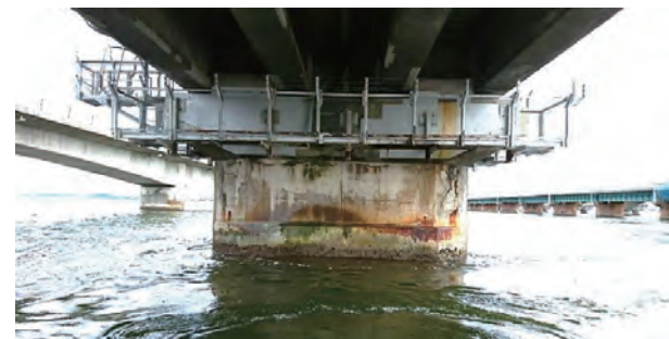
写真2 補強工に発生した塩害状況
