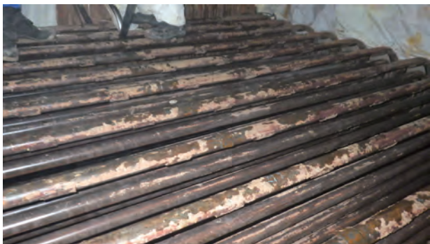
写真2 外面洗浄後過熱器の様子
