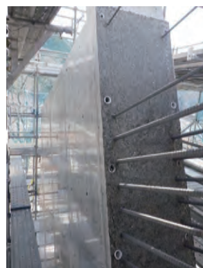
写真4 脱型後の表層状況
