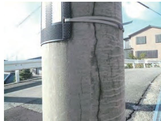
写真5 電柱に生じた縦ひび割れ 4)
