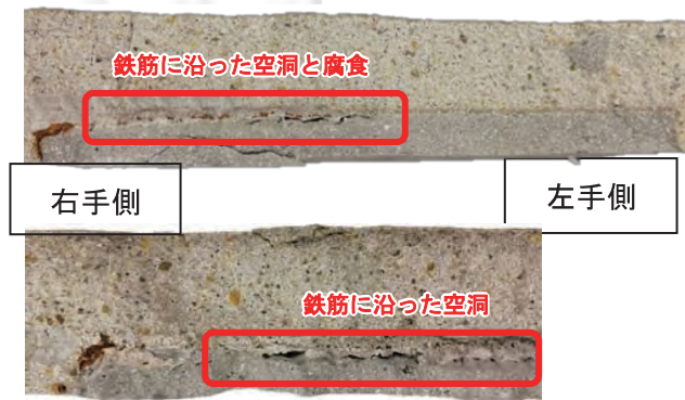
写真3 上向き施工における腐食発生状況
