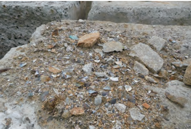
写真2 根固めブロック天端の浮泥
