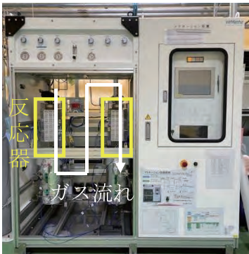
写真3 メタネーション装置の外観
