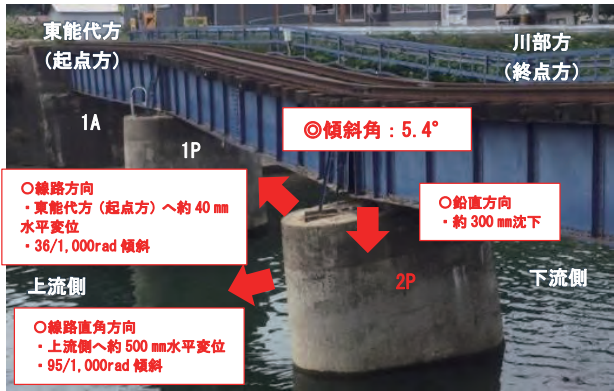
写真2 2P橋脚被災後全景写真
