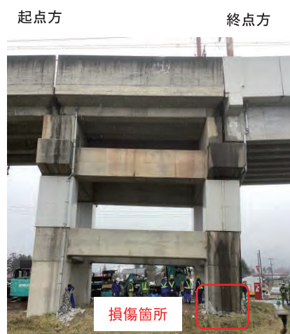
図1 地震直後におけるRCラーメン橋台の損傷状況
