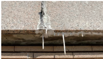
▲橋の上流側(南側)の一部に「つらら」が発生している。
