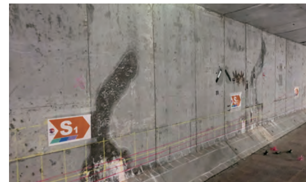
写真3 箱桁内の水浸み
