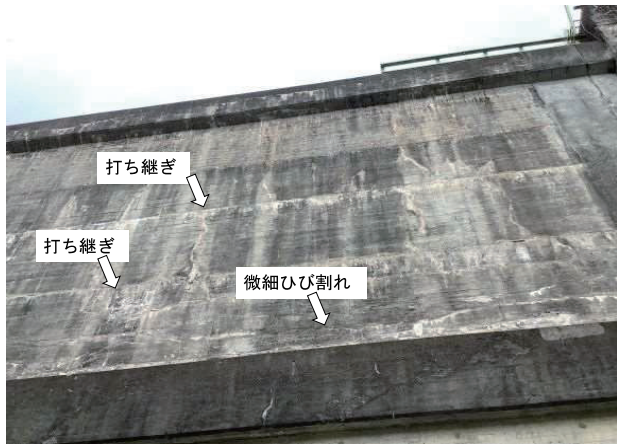
写真3 水路橋側面のひび割れ状況
