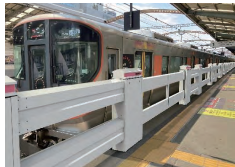
写真1 可動式ホーム柵
