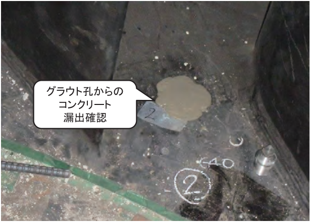
写真7 グラウト孔からのコンクリート漏出状況
