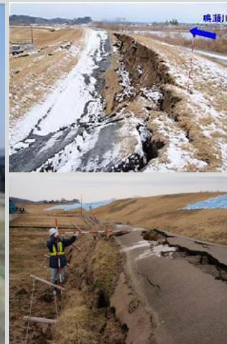
未改良区間の被災状況
