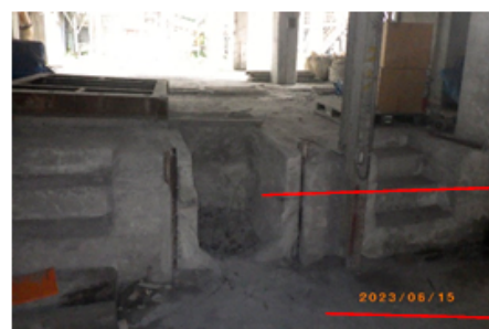
写真4 危険な状態の題材写真
