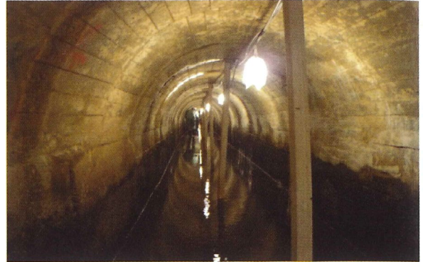
写真-1 補修前状況
