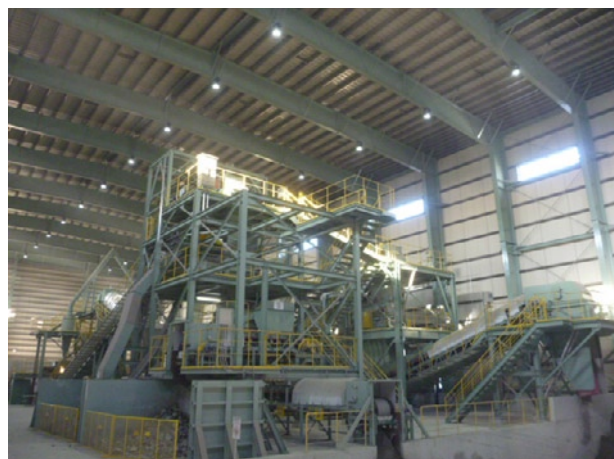
写真12 都市ごみ焼却灰処理設備
