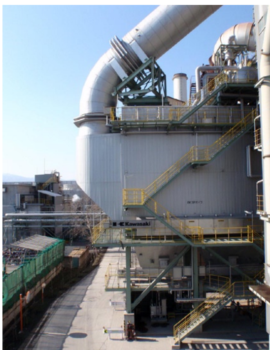
写真11 廃熱発電設備
