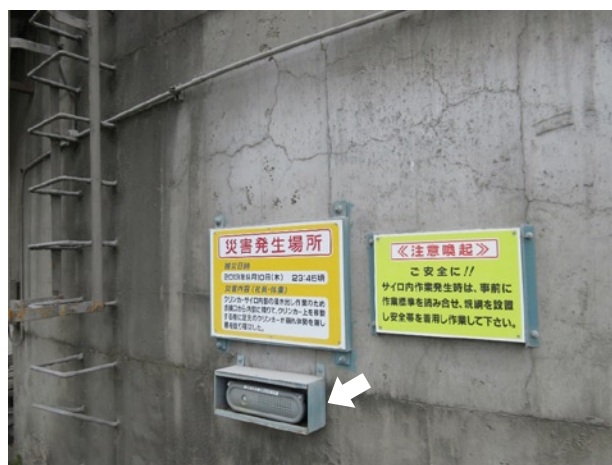
写真5 災害発生場所への看板掲示と ボイストーク(矢印)の設置
