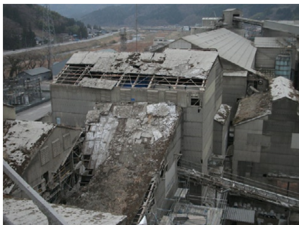
写真7 大震災発生後 場内建屋屋根崩落の様子
