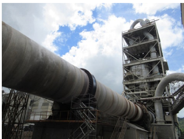
写真4 プレヒーターとキルン
