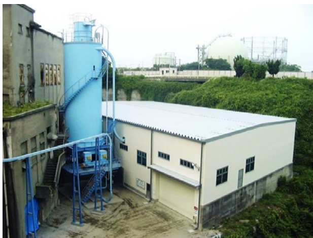
写真5 廃プラスチック類の燃料化設備(破碎設備)
