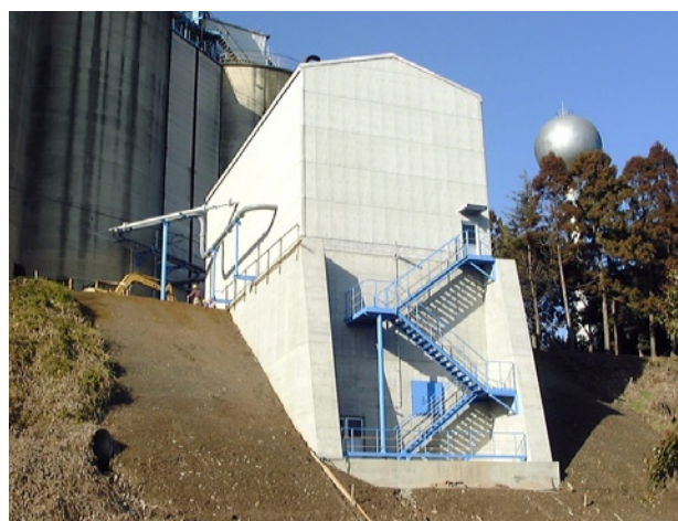
写真4 下水汚泥の受入・貯蔵・搬送設備
