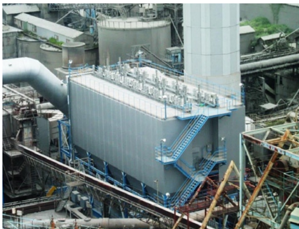
写真6 バグフィルター
