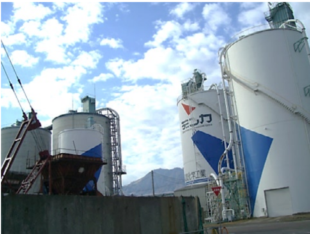
写真5 姫川港に設置した石炭灰サイロ
