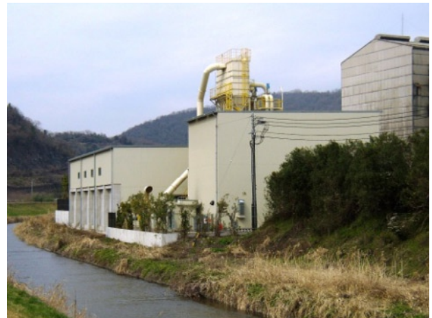
写真4 木くず破碎設備
