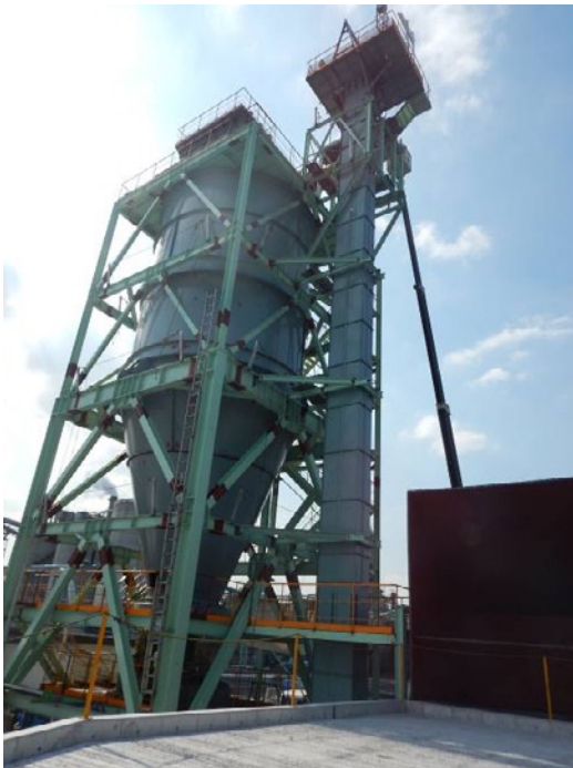
写真7 受け入れ量が増大している 廃石こうボード添加設備
