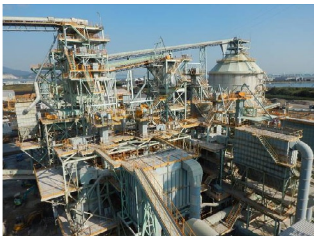
写真4 石灰石砕砂設備では生コン用骨材を製造
