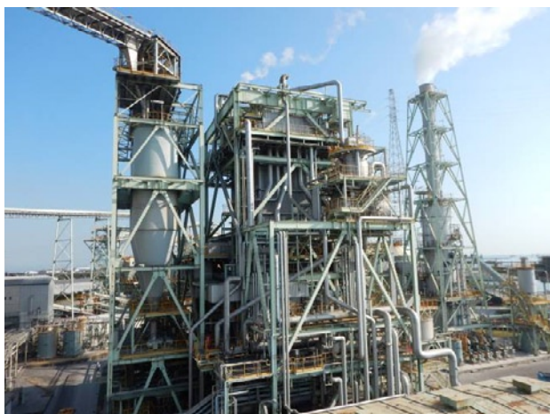
写真5 自家用発電設備で電力は100%自給
