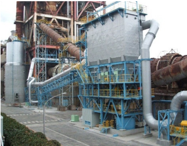
写真2 高塩素バイパス設備
