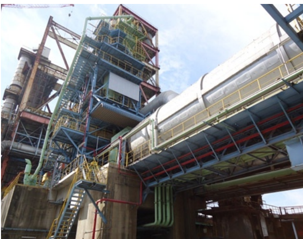
写真3 廃プラ燃料化設備
