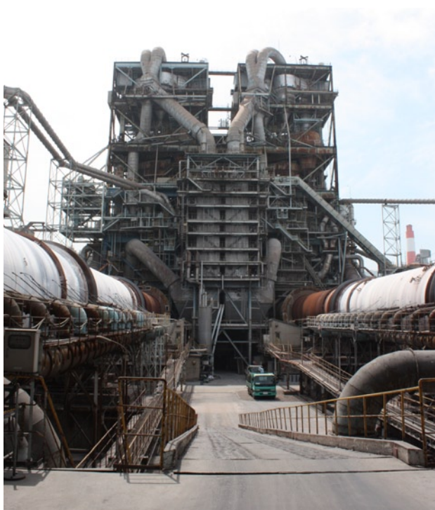
写真5 第二工場の4号/5号キルン
