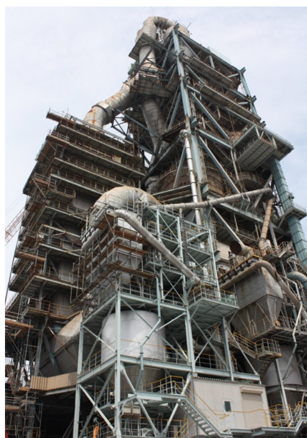
写真9 タワーに併設された廃熱ボイラ(7～11号)
