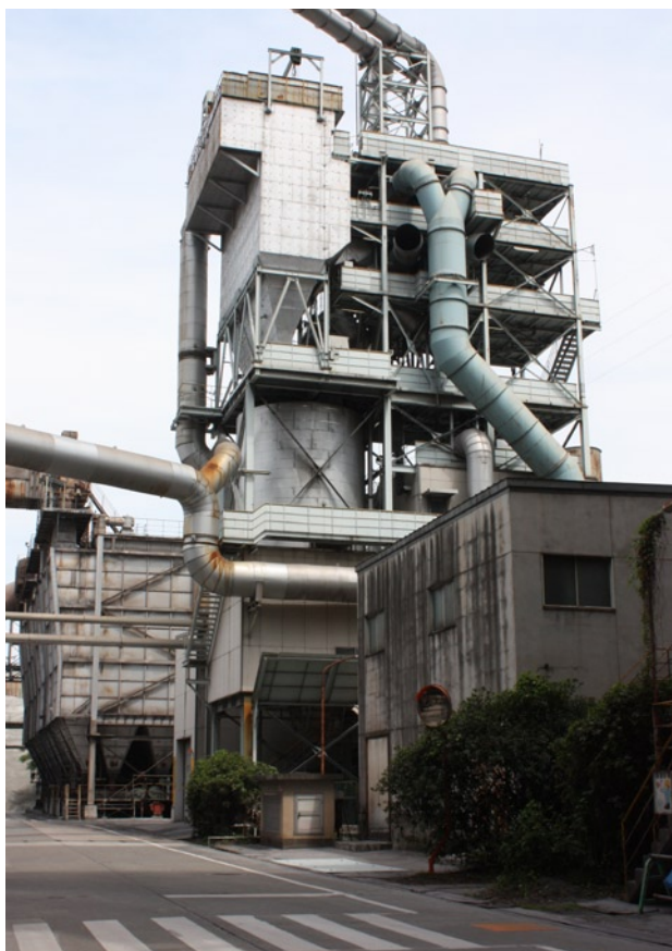
写真10 塩素バイパス設備
