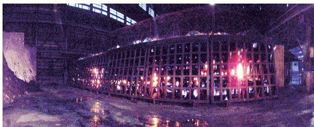
屋久島電工 焼成用アチソン炉
