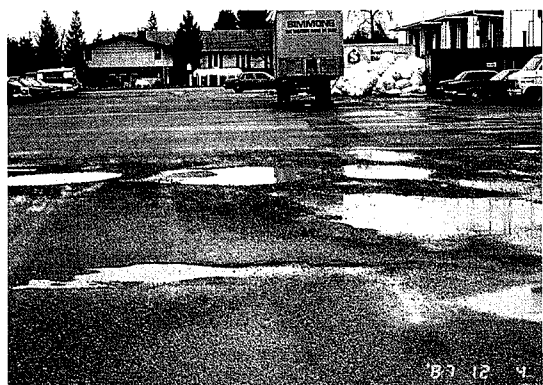
写真5-3 破損している既設のアスファルト舗装
