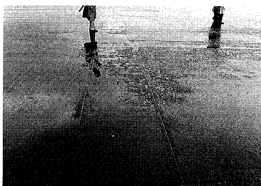
写真4-8 横方向ジョイント部の補修箇所。 RCCP施工延長のほぼ中央部、全横断幅が通常のコンクリートで打換えられている。（写真中央）
