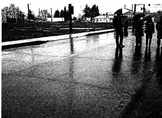
写真4-12 横断ひびわれの発生状況
