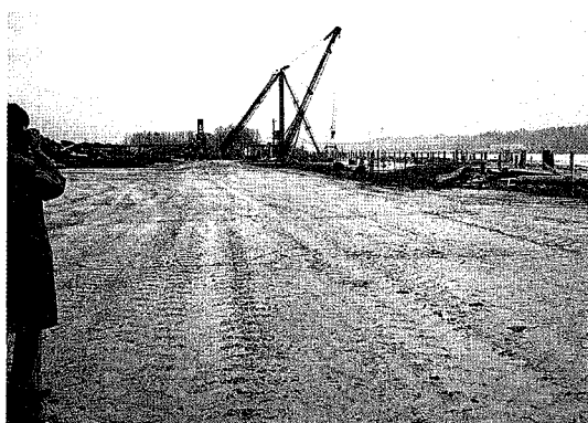
写真5-10 RCCP施工箇所全景。表層にConventional Concreteが用いられているため、RCCPを直接見ることはできないが、表層にはかなり多くのひびわれが発生している。
