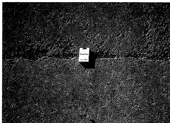
写真 5 - 2 RCCPの一層仕上げ部分と二層仕上げ部分のジョイントの平坦性確保は難しい。
