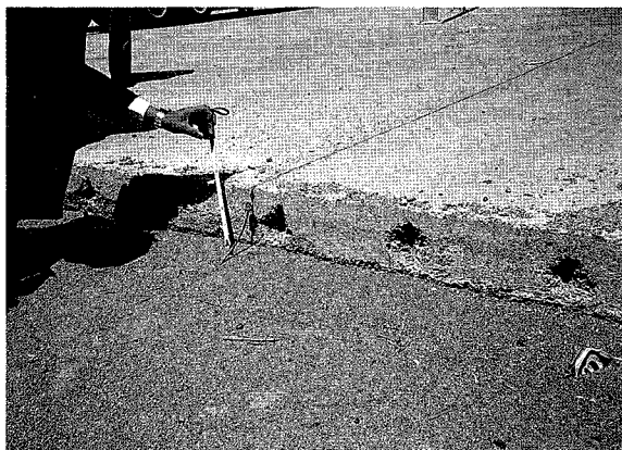
写真 4-6 RCCP (15cm)の打継ぎ部は粗面にするためピックで小穴を開けている、目地にはゴム系シール材使用。
