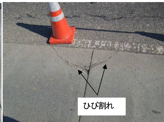
写真 6-2 No. 26～27 のひび割れ
