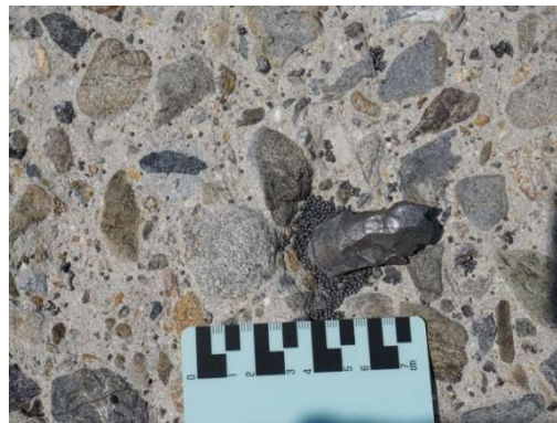
写真－28 床版より露出している鉄筋
