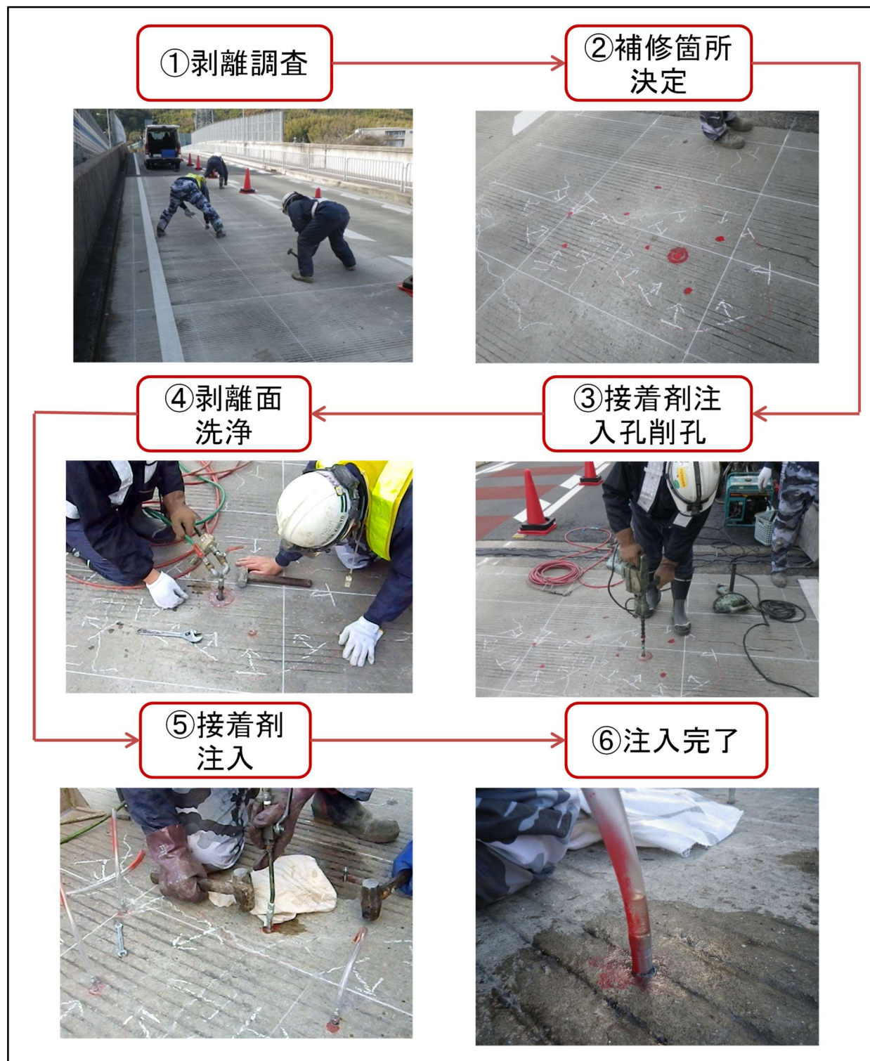
図-40 供用 1.3 年における補修手順
