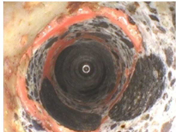
写真-22 可視化したひび割れ
