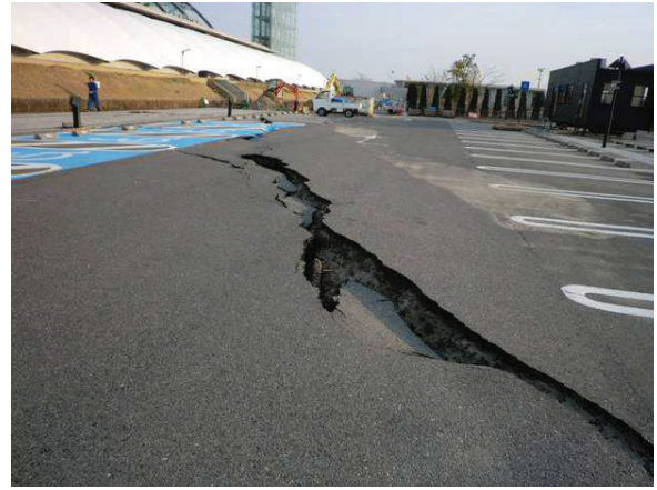
写真 4.3.4 施設周辺の被害状況その2
