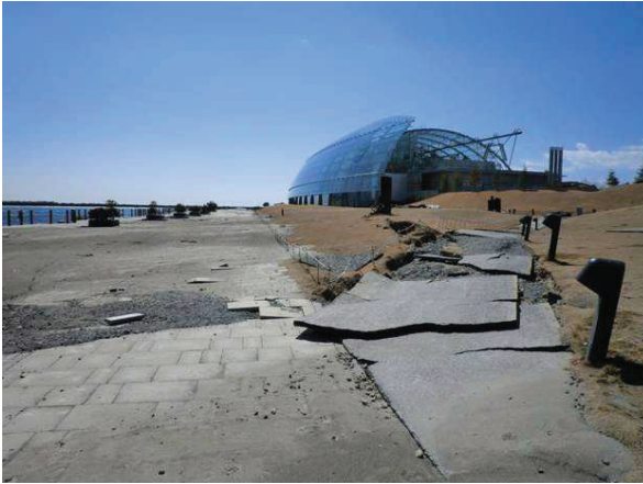
写真 4.3.3 施設周辺の被害状況その1
