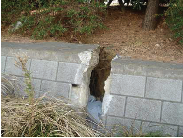
写真 4.5.2 緑地帯擁壁の破損
