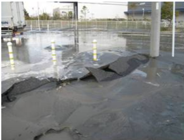
写真 4.5.4 周辺道路の被害状況
