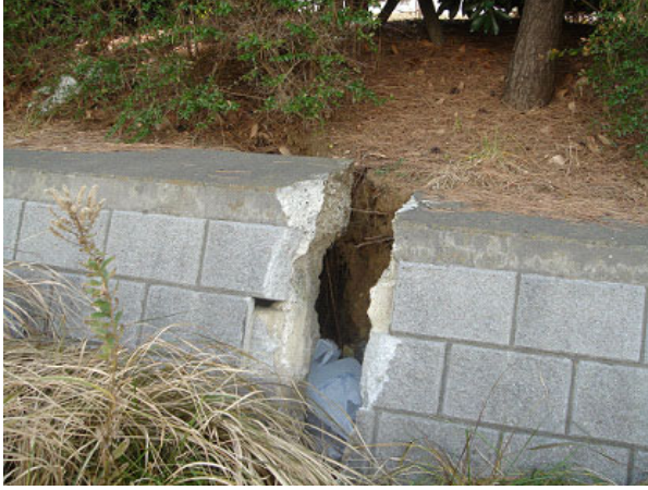
写真 4.5.2 緑地帯擁壁の破損
