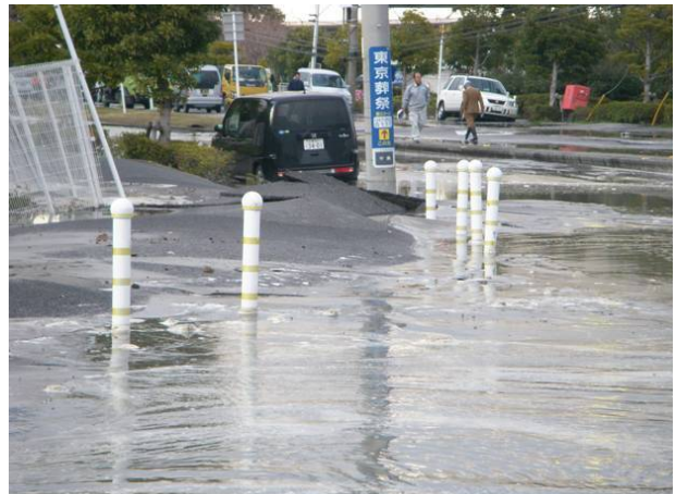
写真 4.5.5 周辺道路の液状化
