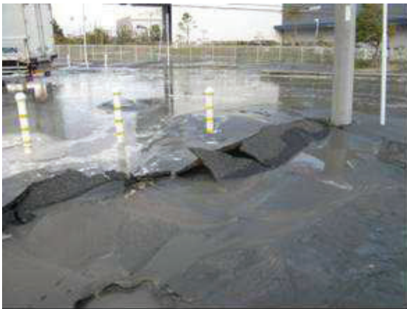
写真 4.5.4 周辺道路の被害状況
