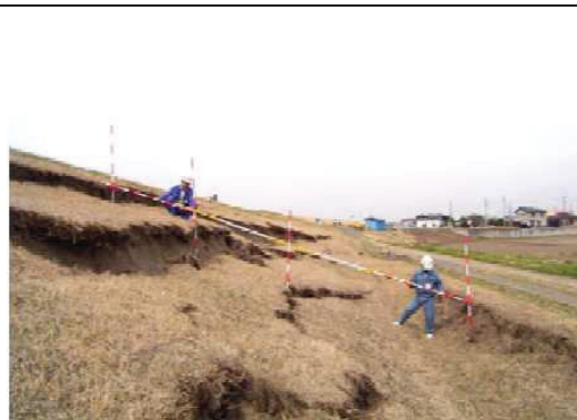
写真② 改良場所より約 3.5km 離れた 堤防天端の沈下 2)
