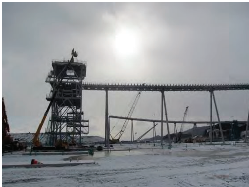
写真 3.2.1 巨大ベルトコンベアの全景
