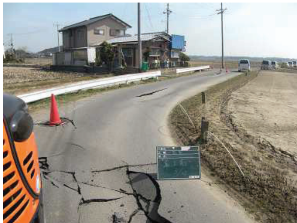
写真 5.2.2 管路の被害状況その 2
