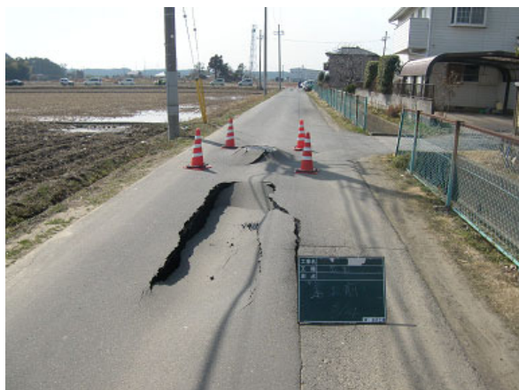
写真 5.2.1 管路の被害状況その1
