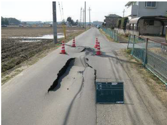
写真 5.2.1 管路の被害状況その 1
