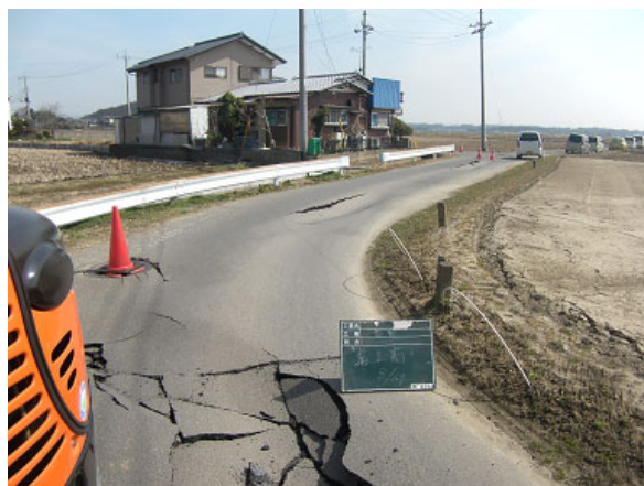
写真 5.2.2 管路の被害状況その2
