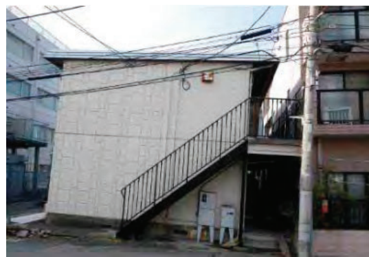
写真 3.3.2 戸建住宅の被害状況 1)
