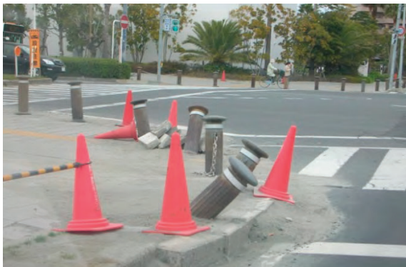
写真 3.3.1 道路部の被害状況
