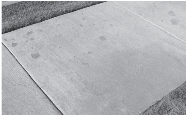
写真3 膜養生剤の早期適用による表面モルタルの剥離
