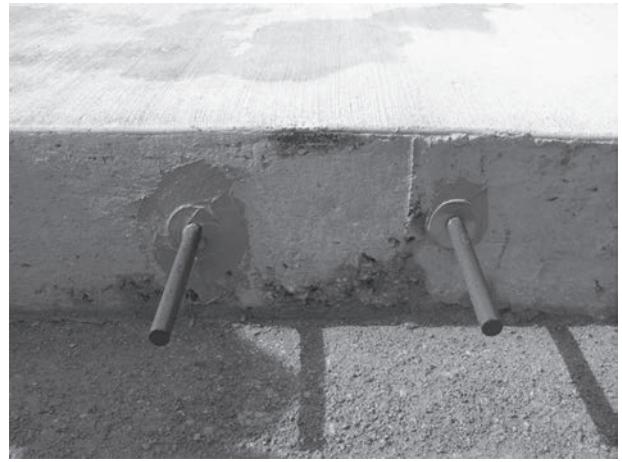
写真2 コンクリート版側面の締固め不足の例
