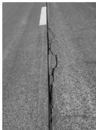
写真1 縦目地の開きとひび割れ
